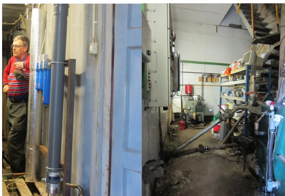
Kuva 7: Heikki Junntila ja biokaasun puhdistuslaitteisto sekä kaasupoltin, jolla tuotetaan lämpö.
